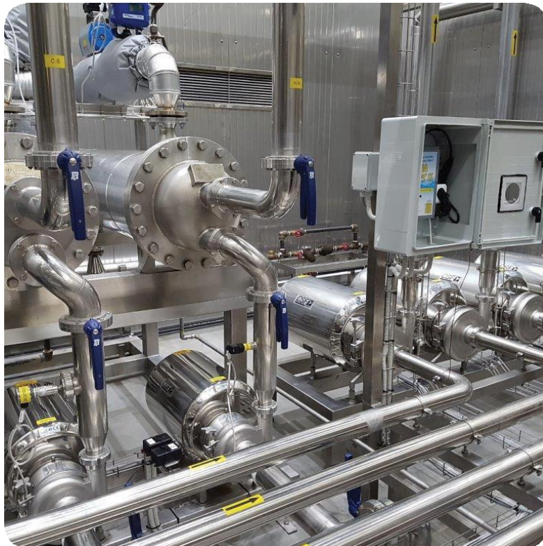
Εναλλάκτης ατμού νερού
